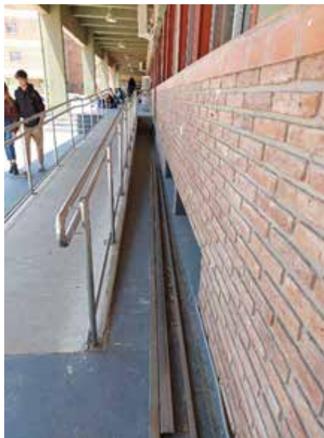
Barrera 7: Peligroso espacio “abierto” entre la rampa y la pared, que no presenta delimitación con algún elemento como un tope o zócalo de cemento.
