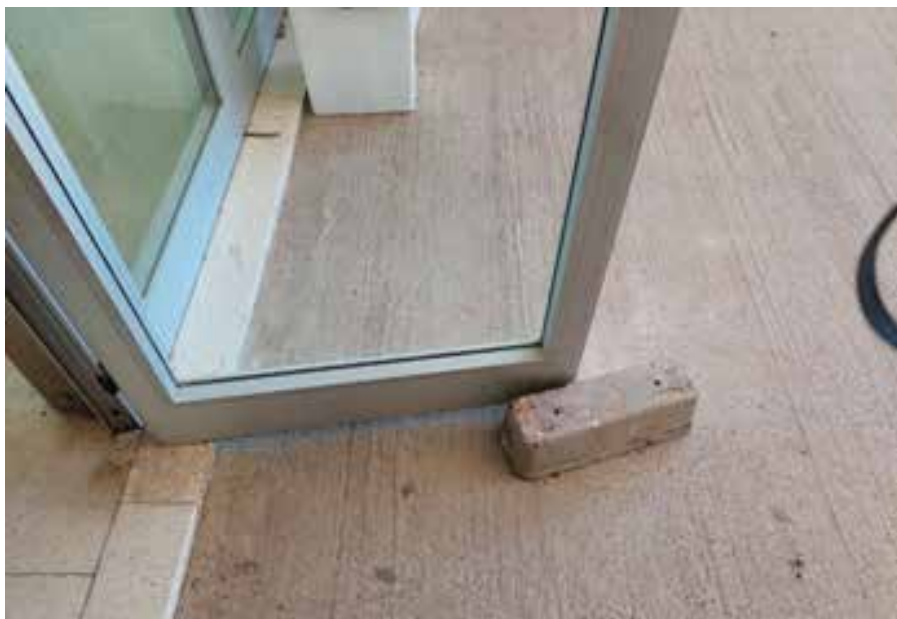
Barrera 9: Pieza de hormigón funcionando como “tope” de la puerta de Ingreso al Aulario.
