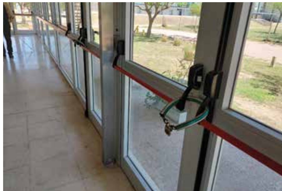
Barrera 9: Puertas de emergencia cerradas con cadena y candado.
