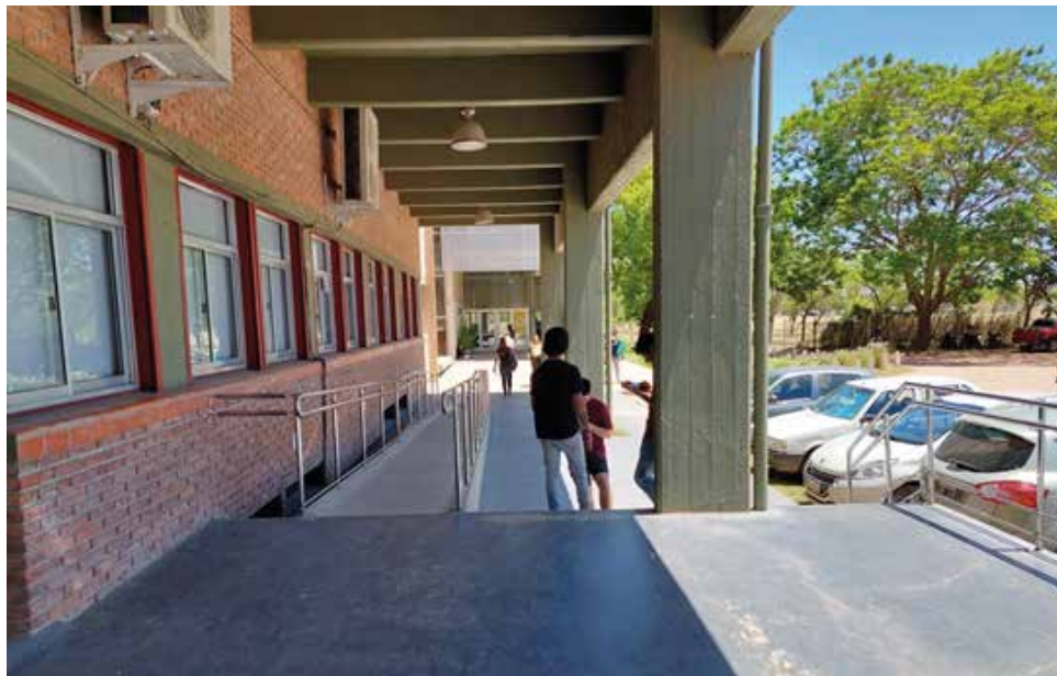
Barrera 7: Rampa sin señalización ni demarcación con baldosas podotáctiles.
